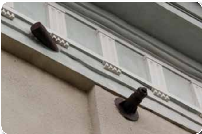
Kościół w Czarnym Ostrowie. Widoczne w murze niewypały artyleryjskie.
